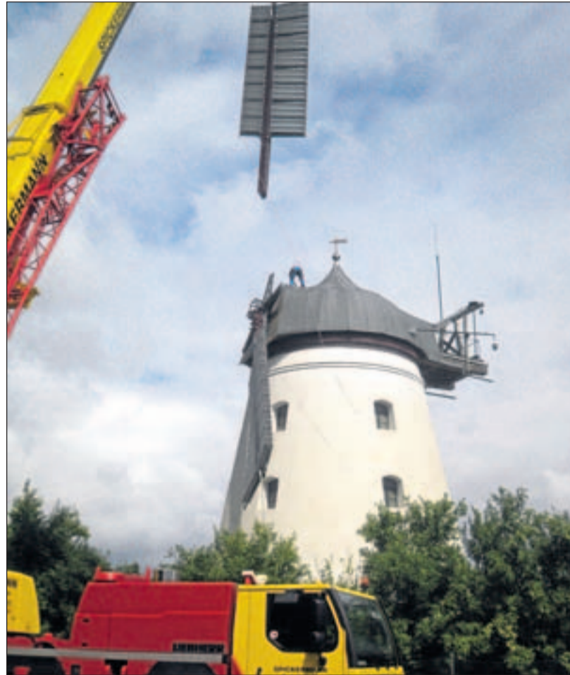
Erst im vergangenen Jahr hatte die Mühle in Wendhausen neue Flügel bekommen. Nun müssen sie wieder abgenommen werden. Archivfoto: Mai
