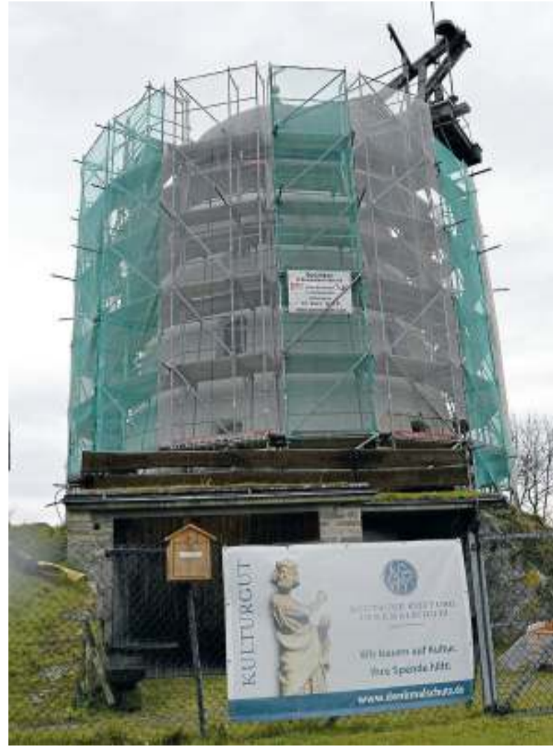
Komplett eingerüstet ist die Windmühle derzeit. Unter anderem bekommt das Baudenkmal einen neuen Außenputz.
